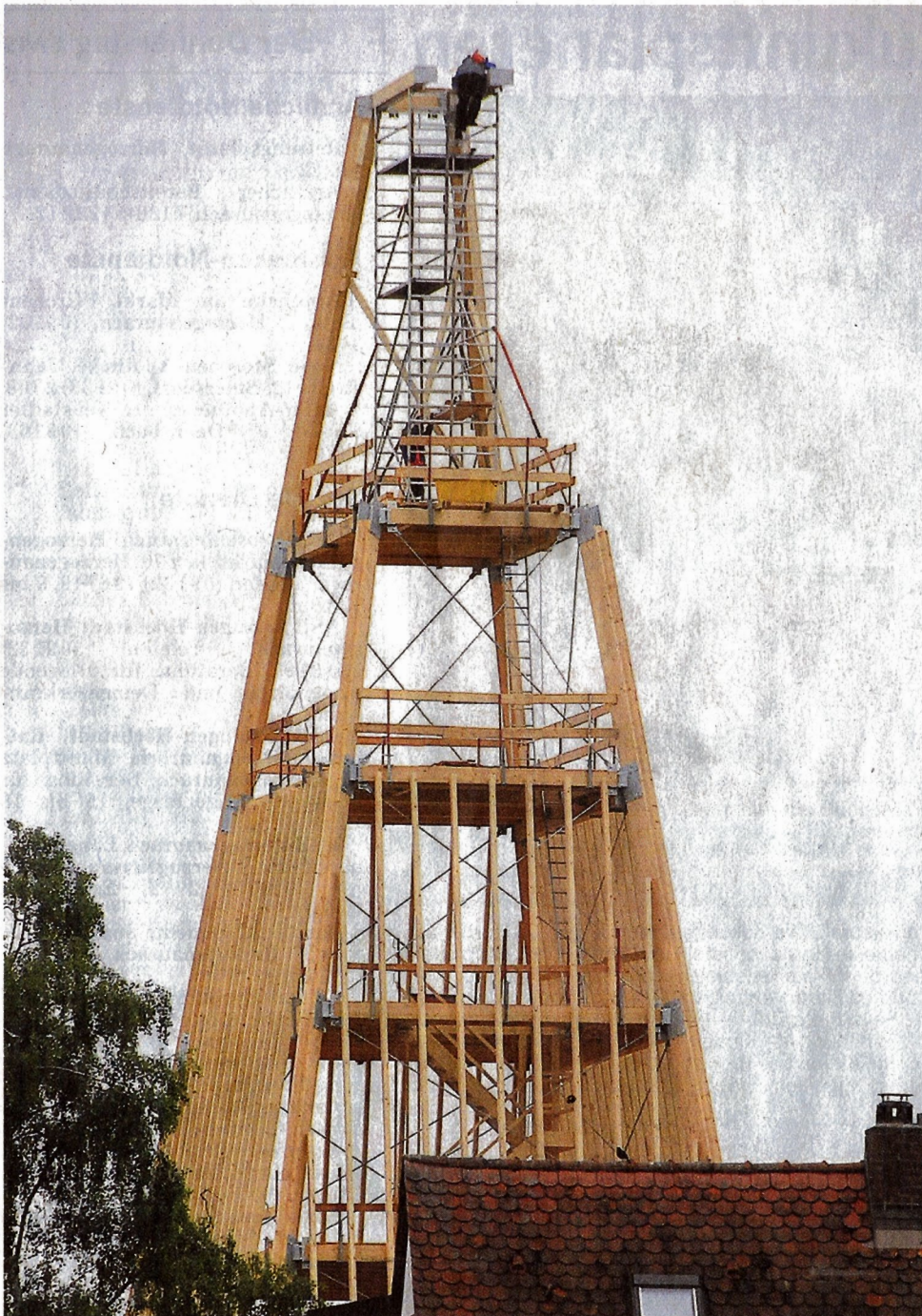
Nichts für schwache Nerven: Die Zimmerer Patrice Voigt und Marcus Deppe leisten oben im Gebälk ganze Arbeit. Foto: Kronau
